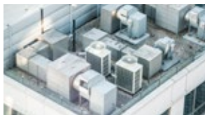
Vykurovanie, vetranie a klimatizácia (HVAC)
