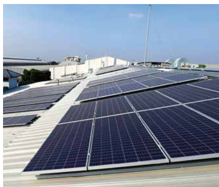
Inštalácie fotovoltaických systémov sú schopné zaujímavu znížiť náklady na spotrebu elektrickej energie a zároveň priniesť vedľajšie benefity. (zdroj: iStock.com)
