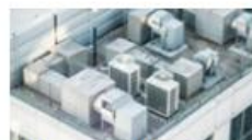
Riscaldamento, ventilazione e raffreddamento (HVAC)
